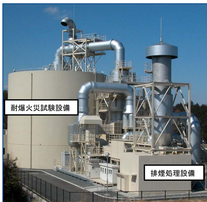
耐爆火災試験設備と排煙処理設備の外観
